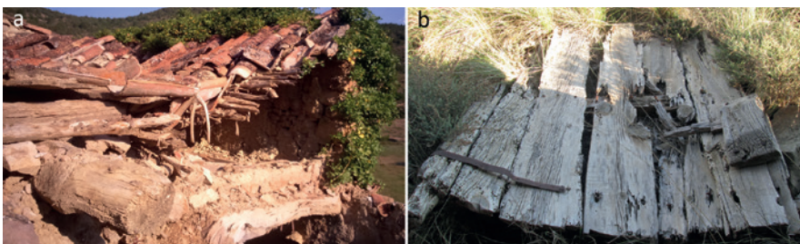
Figura 3.19. Materia vegetal y madera en edificaciones contemporáneas abandonadas. a. Troncos y varas del interior de una cubierta (Abejuela, Teruel). b. Restos de una puerta de madera, caída junto al vano de entrada (Hortichuela, Valencia).
