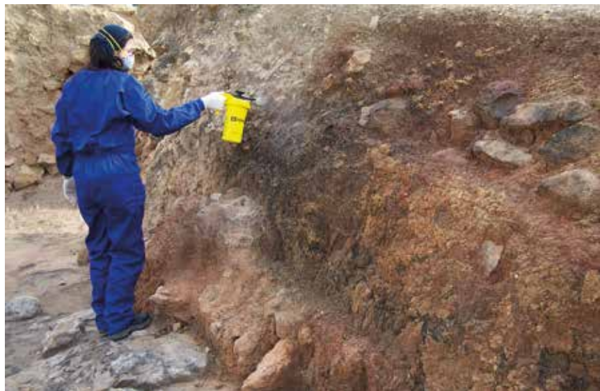
Fig. 2. Consolidació in situ dels revestiments de mur per mitjà de polvorització de silicat d'etil.
